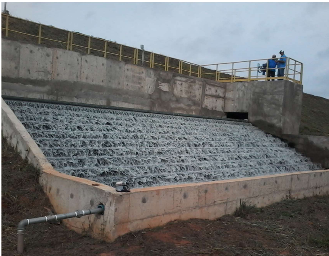
Escada Hidraulica de Tratamento do Efluente Final que retonar ao Rio São Domingos.
