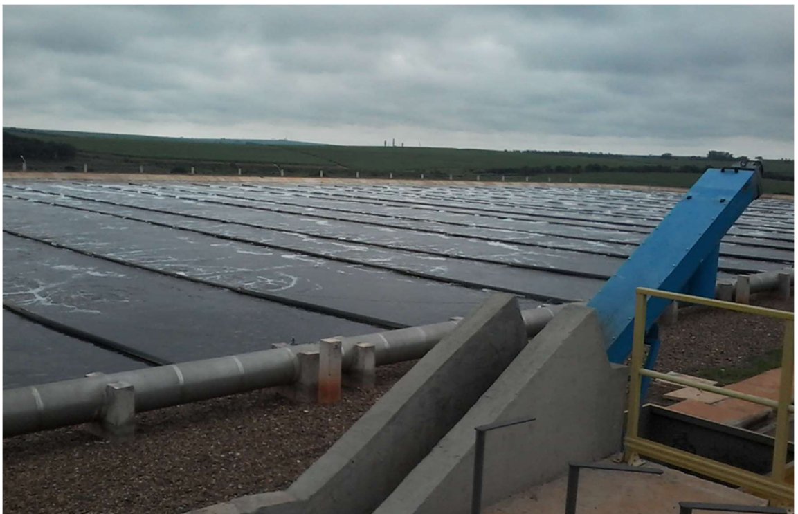
Lagoa de Aeração ETE Catanduva
