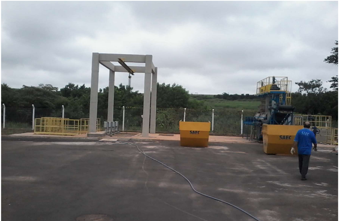
Elevatória de Esgoto/ Caçamba de Resíduos
