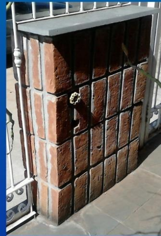
VISÃO TRASEIRA DA CAIXA INSTALADA
