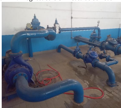
Figura 4-12: Diagnóstico UC1 - Casa de bombas
