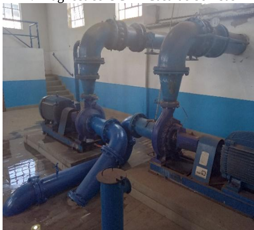
Figura 4-11: Diagnóstico UC1 – Casa de bombas
