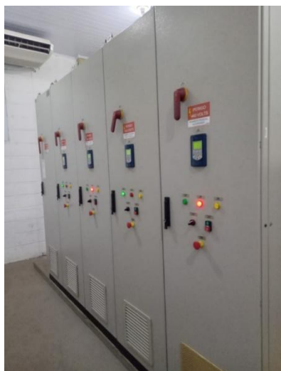
Figura 4-17: Diagnóstico UC2 - Painéis Elétricos
