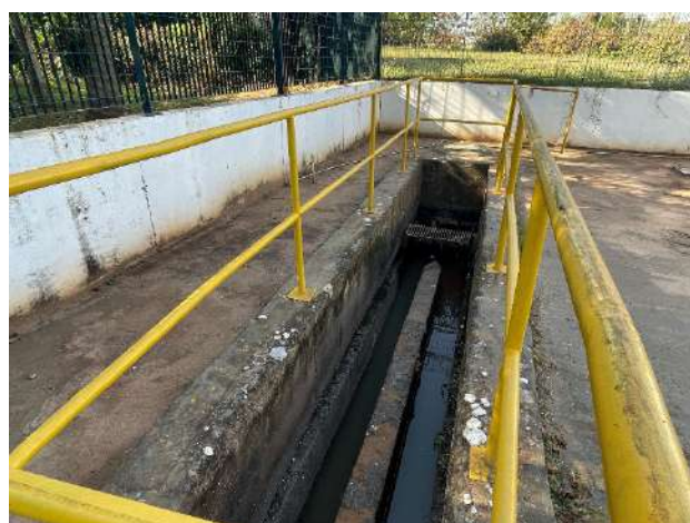
Figura 1.39. Canal com gradeamento e caixa de areia da EEEB5.
