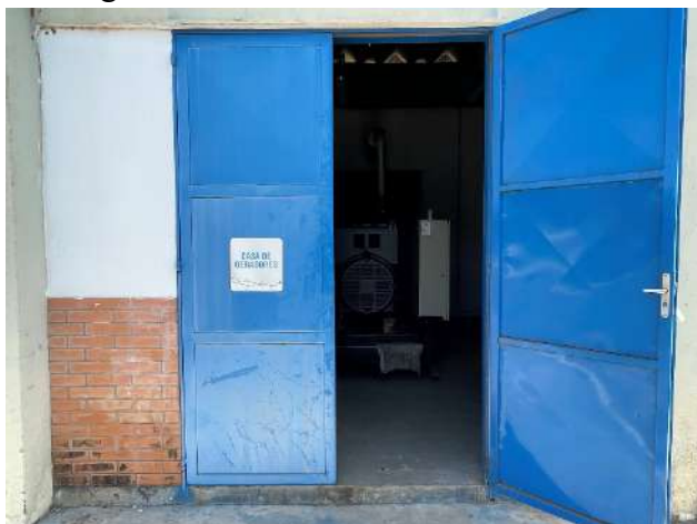
Figura 1.18. Casa de Geradores EEEB1.
