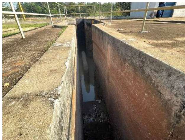
Figura 1.57. Canal com gradeamento e caixa de areia da EEEB8.
