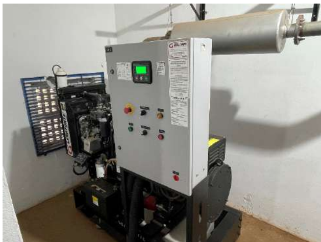
Figura 1.30. Gerador de energia e painel de elétrico da EEEB3.
