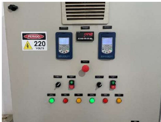
Figura 1.31. Painel elétrico da EEEB3.
