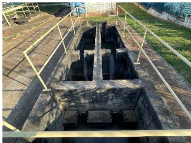
Figura 1.33. Canal com gradeamento e caixa de areia da EEEB4.
