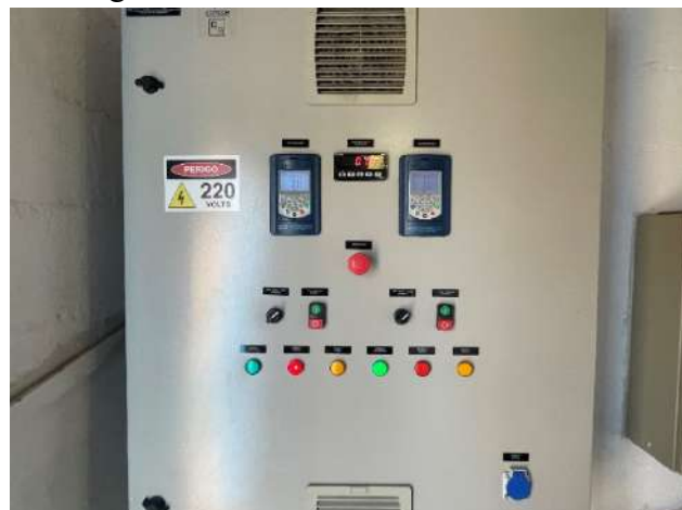
Figura 1.25. Painel elétrico da EEEB2.
