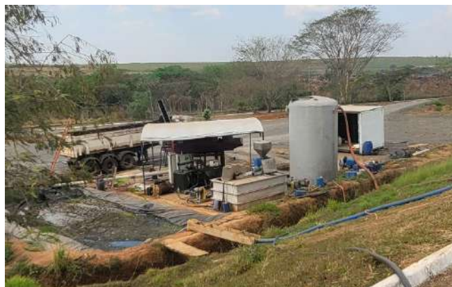
Figura 1.132. Unidade remota de tratamento do lodo
