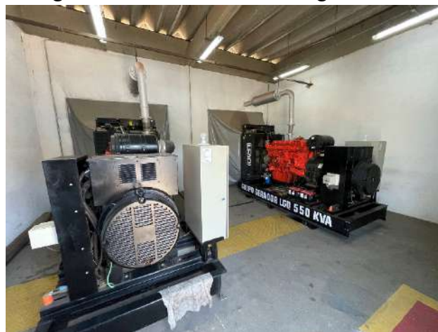
Figura 1.19. Geradores de Energia EEEB1.
