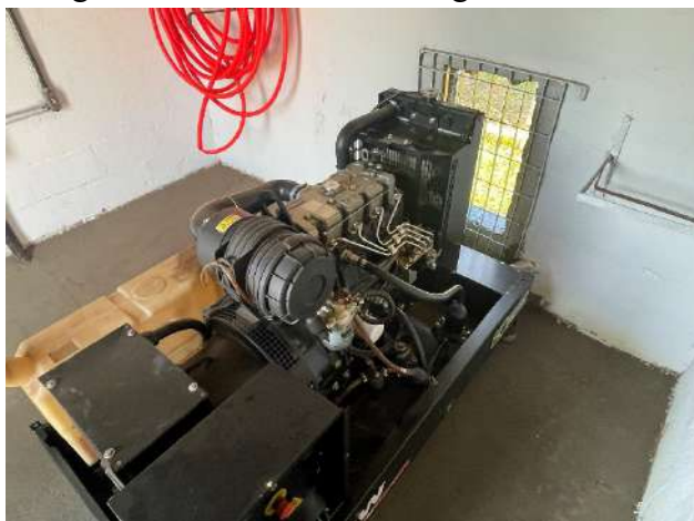
Figura 1.24. Gerador de energia da EEEB2.
