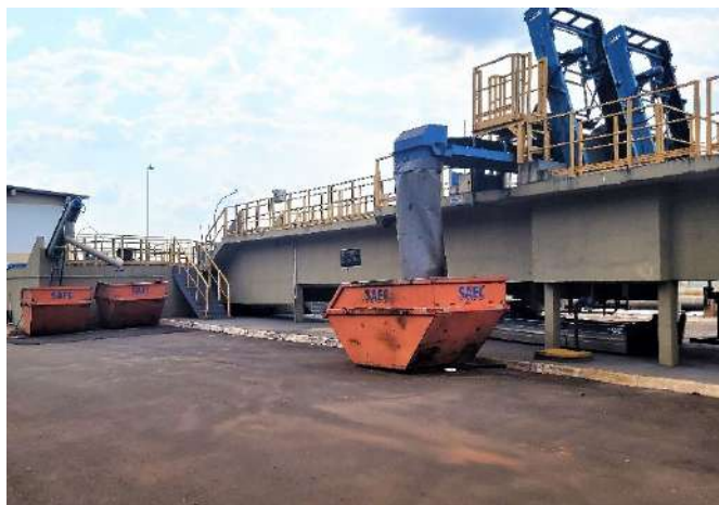
Figura 1.83. Vista externa do Tratamento Preliminar da ETE.
