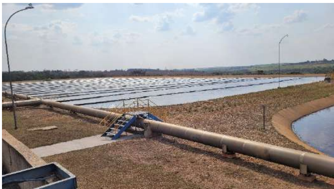
Figura 1.113. Vista 3 Lagoas Aeradas da ETE.
