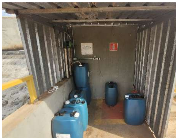
Figura 1.130. Dosador de antiespumante
